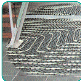
Chauffage par le sol
